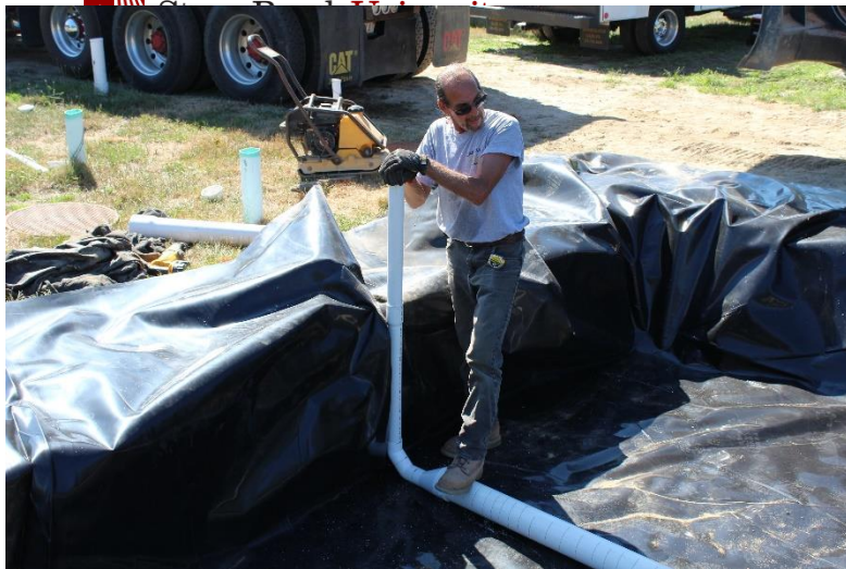
Effluent collection port
